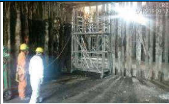
Foto 2.- Corte de Micropilotes para el entronque entre Acceso No 8 y la Losa de Arriostamiento a nivel de Vestíbulo.
