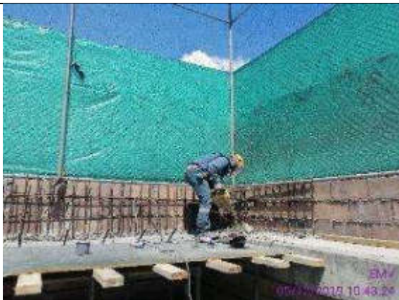
Foto 13.- perforaciones para colocación de anclajes para el recrecido de boca de acceso 2
