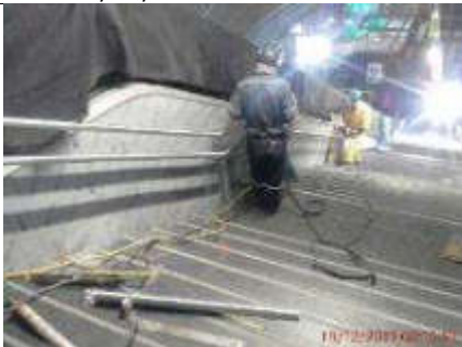
Foto 16.- 18/12/2019. Instalación de los pasamanos de las escaleras tramo losa andén a losa de vestíbulo.
