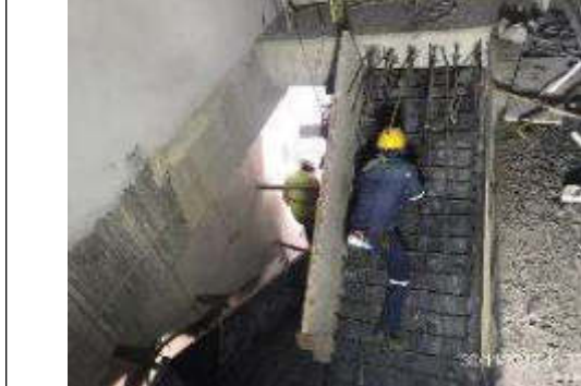
Foto 7.- Montaje de armadura estructural en escaleras losa BT hacia losa de entreplanta.
