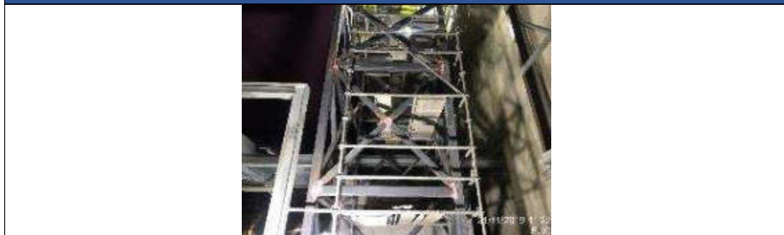
Foto 1.- Ensayo de tintas penetrantes en soldadura de castilletes de ascensores nivel losa de andén.
