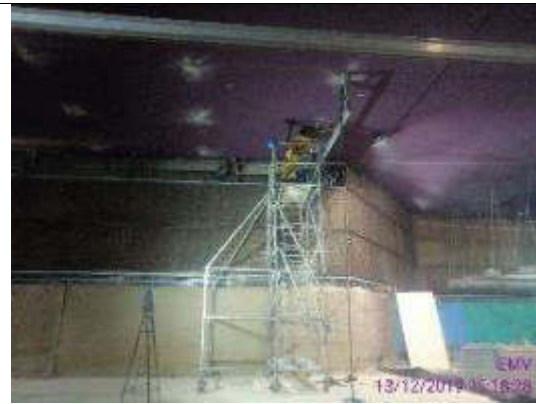
Foto 20.- Perforaciones en techo andén anclajes de la estructura de conducto de ventilación
