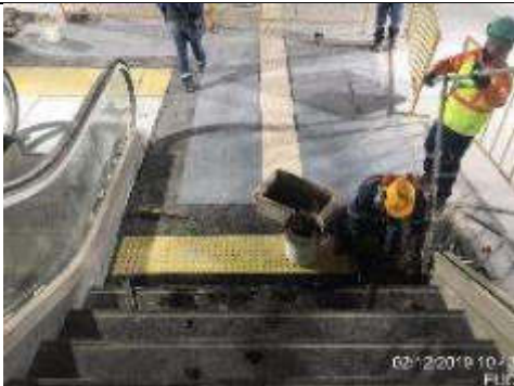
Foto 6.- Colocación de porcelanato alcalagres y de botones a nivel losa de vestíbulo junto a la escalera mecánica cabecera sur.
