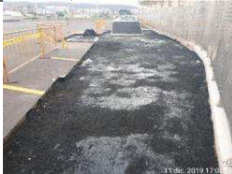
Foto 5.- Imprimación de superficie de salida de emergencia previo a colocación de asfalto
