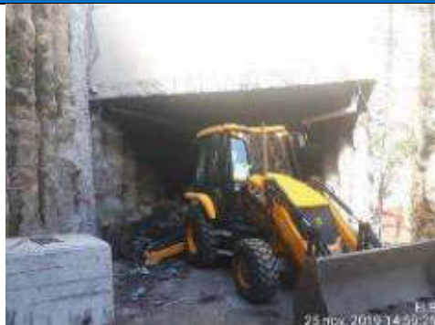
Foto 2.- Excavación para construcción de zapata de muro de cierre para rampa de vaciado
