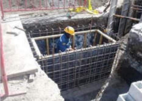
Foto 3.- Encofrado de hastiales de pozo Z1 conexión con red de saneamiento existente.
