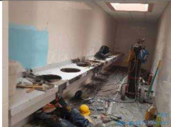
Foto 37.- Colocación de encimeras en cuartos de baño de segunda planta de edificio administrativo.
