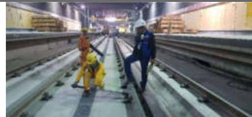
FOTO 03: 30-11-19.- Verificación de torque en los tramos del Sur, faltantes de nivelación.
