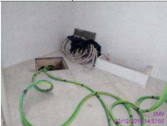
Foto 19.- cableado de gradas mecánicas en cuartos ESC
