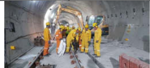
FOTO 04: 28-11-19.- Desmontaje de rieles en la zona de tratamiento, tramo Solanda - Cardenal de la Torre.
