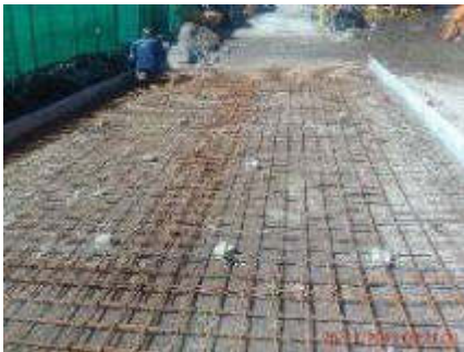
Foto 3.- 25/11/2019. Colocación de malla electrosoldada para la fase 3 de la base del adoquín.
