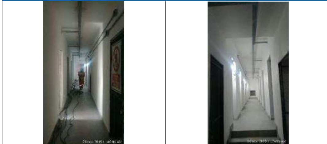
Foto 1.- perfilería para suspensión de tubería de alta presión para sistema contraincendios
