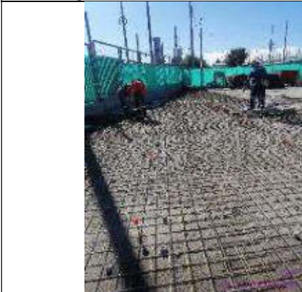
Foto 7.- colocación de malla para pavimento en la zona de ingreso a parqueaderos
