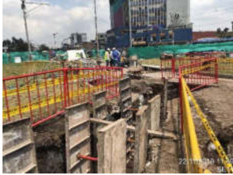
Foto 1.- Excavación de zanja para colocación de tubería red de saneamiento nivel superficie.
