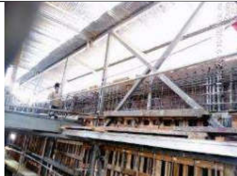
Foto 20.- 11/12/2019. Armadura del último tramo en muro fachada que da a calle Benalcázar.
