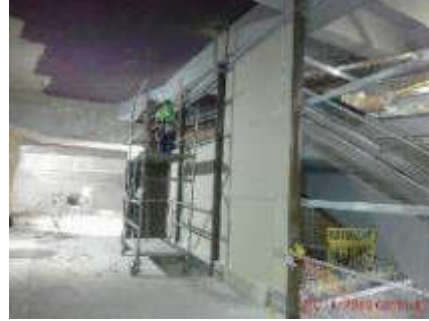
Foto 4.- 28/11/2019. Colocación de gypsum parte posterior de la perfilería del italfim a nivel de entreplanta.
