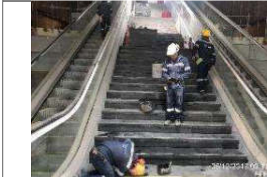
Foto 9.- Colocación de granito en peldaños de escaleras desde losa de mezzanina a nivel vestíbulo.
