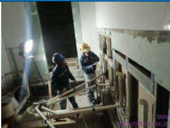
Foto 9.- colocación de refuerzo para lavamanos en estructura de gypsum, en aseos de vestíbulo
