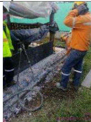
Foto 12.- picado de muro para colocación posterior de borde de templete de ascensor vestibulo - superficie
