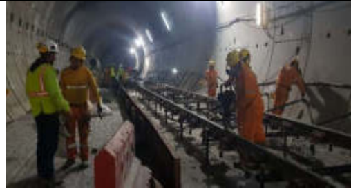
FOTO 10: 05-12-19. Montaje de vía de reposición en el tramo Solanda - Cardenal de la Torre.
