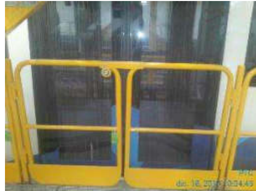
Foto 34.- Montaje de estructura metálica en vías de mantenimiento, se colocan puertas en barandillas.
