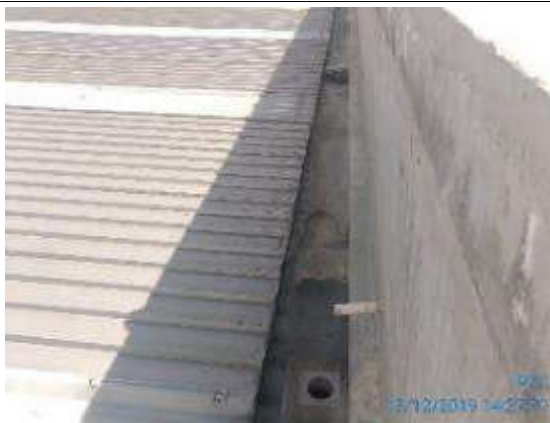
Foto 25.- Evacuación de agua atrapada de las perforaciones realizadas en losa de cubierta de edificio administrativo.
