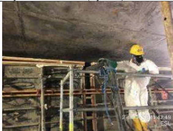
Foto 3.- Vaciado de hormigón de los muros forros acceso 2 lado oeste, V=66 m3, f'c=30 MPa.
