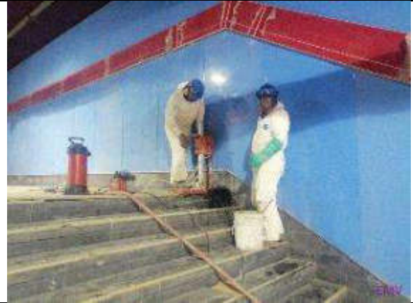
Foto 6.- perforación para posterior colocación de pedestales de pasamanos de acero inox. En pasillo acceso 1 y 2
