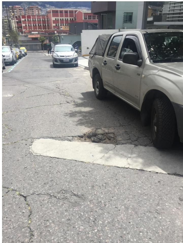
Ilustración 6: Bache en la Salazar y Destruje
