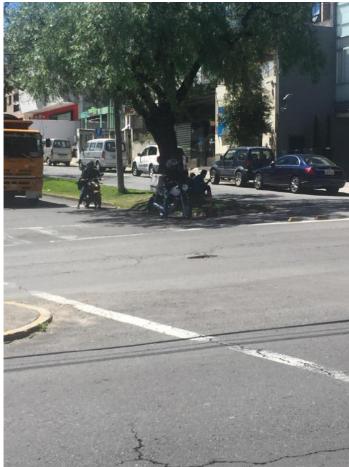
Ilustración 10: Bache en la Orellana y Coruña.
