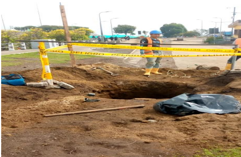
Señalización en pozos
