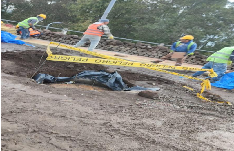
Señalización en pozos
