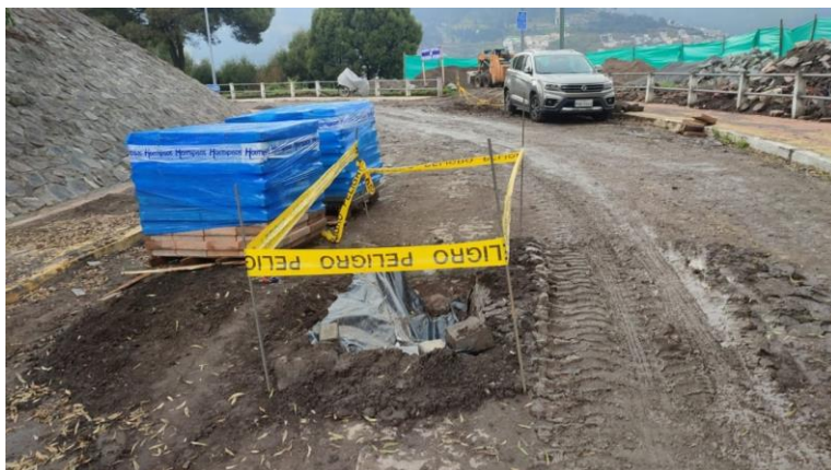
Señalización en pozos
